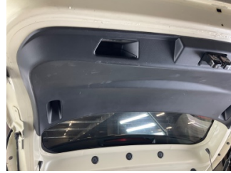
Döşemeler/Kapaklar, Döşemeler/Kapaklar > Çizik
