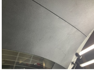
Döşemeler/Kapaklar, Döşemeler/Kapaklar > Deforme Olmuş
