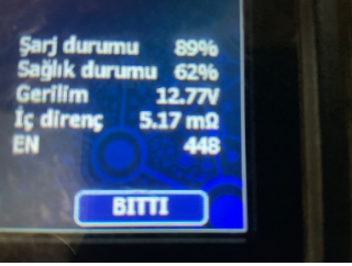
Elektrik donanımı/Pano, Akü > Test Sonucu
