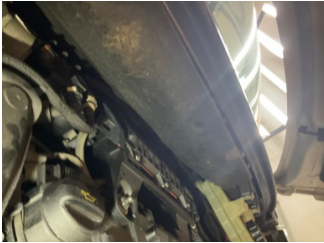
Motor, Motor izolasyonu > Hasarlı
