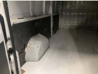
Döşemeler/Kapaklar, Bagaj bölümü döşemesi > Ezik
