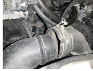
Motor, Hava filtresi kabı > Sabitlemesi Hatalı
