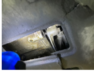
Şanzıman, Şanzıman > Yağ Kaçağı
