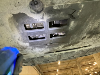
Motor, Alt muhafaza > Hasarlı
