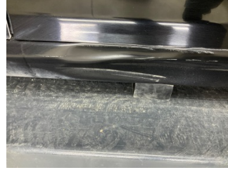
Marşbiyel, sol, Marşbiyel, sol > Hasarlı
