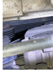
Motorsoğutması, Kayış > Çatlak
