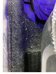
Döşemeler/Kapaklar, Döşemeler/Kapaklar > Yakıcı Madde ile Zarar Görmüş
