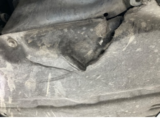
Motor, Alt muhafaza > Hasarlı
