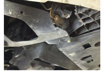
Motor, Alt muhafaza > Hasarlı
