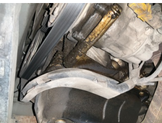
Motor, Motor > Yağ Kaçağı
