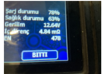
Elektrik donanımı/Pano, Akü > Test Sonucu
