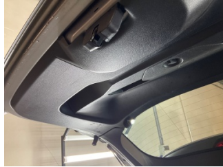
Döşemeler/Kapaklar, Döşemeler/Kapaklar > Çizik
