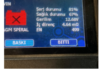
Elektrik donanımı/Pano, Akü > Test Sonucu
