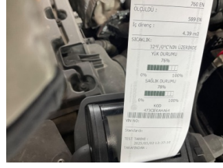
Elektrik donanımı/Pano, Akü > Test Sonucu
