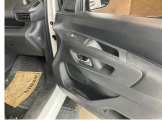
Döşemeler/Kapaklar, Döşemeler/Kapaklar > Deforme Olmuş
