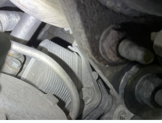
Motor, Motor > Yağ Kaçağı
