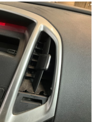
Kalorifer/Klima, Havalandırma ızgarası sabitlemesi > Hasarlı
