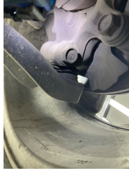
Ön aks, Salıncak, ön sol üst > Hasarlı
