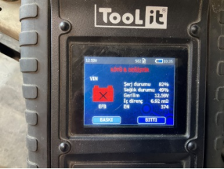
Elektrik donanımı/Pano, Akü > Test Sonucu
