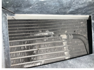
Motorsoğutması, Radyatör > Hasarlı
