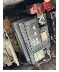
Elektrik donanımı/Pano, Akü > Onaysız
