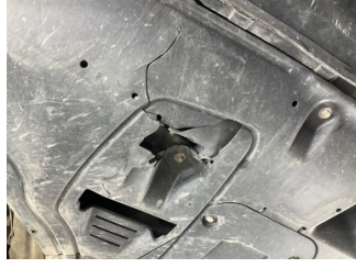
Motor, Alt muhafaza > Hasarlı
