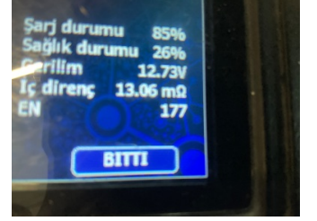
Elektrik donanımı/Pano, Akü > Test Sonucu
