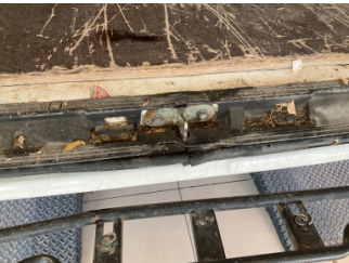
Kaporta, Bagaj kapağı fitili > Hasarlı
