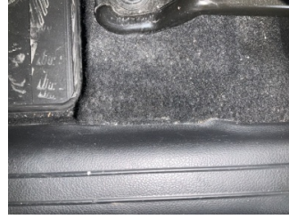
Döşemeler/Kapaklar, Döşemeler/Kapaklar > Yakıcı Madde ile Zarar Görmüş
