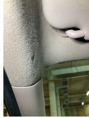
Döşemeler/Kapaklar, Döşemeler/Kapaklar > Yakıcı Madde Ile Zarar Görmüş
