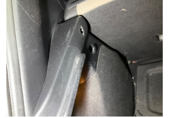
Döşemeler/Kapaklar, Pandizot > Kırılmış
