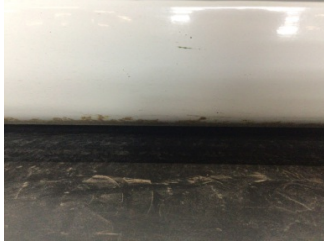
Marşbiyel, sağ, Marşbiyel, sağ > Pas
