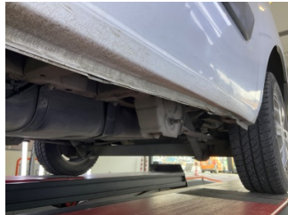
Marşbiyel, sol, Marşbiyel, sol > Hasarlı
