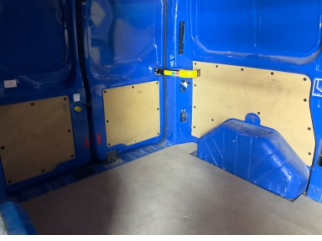
Döşemeler/Kapaklar, Döşemeler/Kapaklar > Deforme Olmuş
