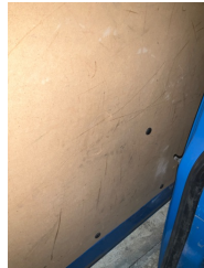
Döşemeler/Kapaklar, Döşemeler/Kapaklar > Hasarlı
