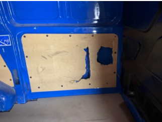
Döşemeler/Kapaklar, Döşemeler/Kapaklar > Hasarlı
