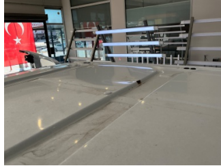
Tavan, Tavan > Hasarlı
