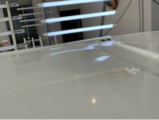
Tavan, Tavan > Hasarlı
