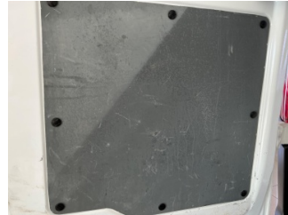
Döşemeler/Kapaklar, Döşemeler/Kapaklar > Çizik
