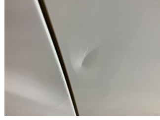
Kapı, sağ arka, Kapı, sağ arka > Ezik
