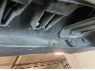
Tampon, arka, Bağlantı ayağı > Hasarlı
