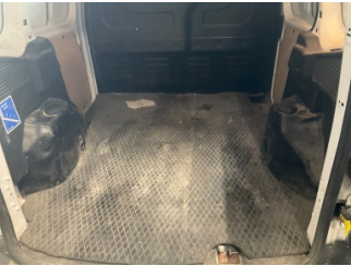
Döşemeler/Kapaklar, Döşemeler/Kapaklar > Deforme Olmuş
