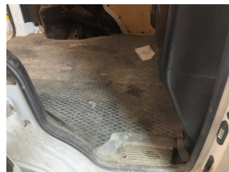
Döşemeler/Kapaklar, Döşemeler/Kapaklar > Kirlenmiş
