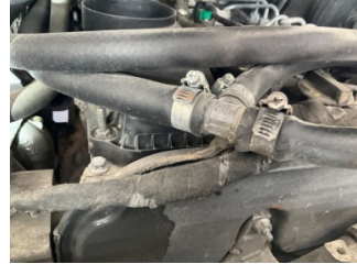
Motorsoğutması, Hortumlar > Standart Dışı Onarım
