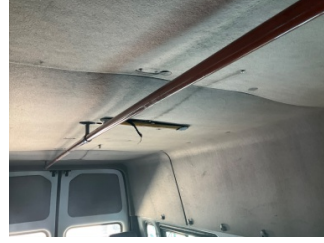
Döşemeler/Kapaklar, Tavan döşemesi > Deforme Olmuş
