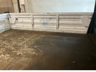
Döşemeler/Kapaklar, Döşemeler/Kapaklar > Çizik
