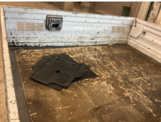
Döşemeler/Kapaklar, Döşemeler/Kapaklar > Boyası Atmış
