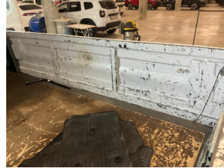
Döşemeler/Kapaklar, Döşemeler/Kapaklar > Boyası Atmış
