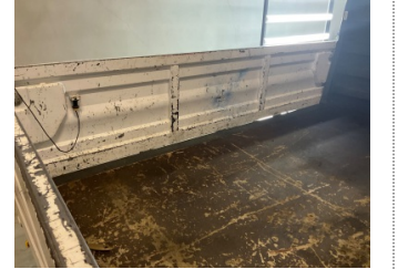
Döşemeler/Kapaklar, Döşemeler/Kapaklar > Boyası Atmış
