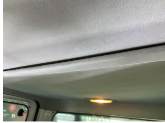
Döşemeler/Kapaklar, Tavan döşemesi > Sabitlemesi Hatalı
