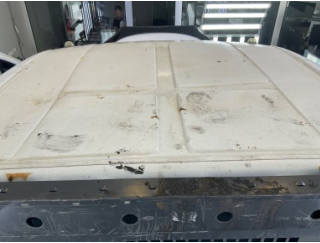
Tavan, Tavan > Hasarlı
