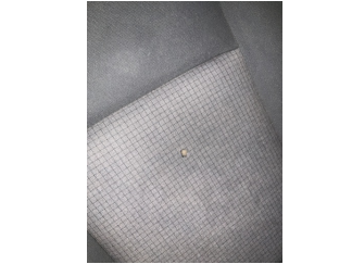
Döşemeler/Kapaklar, Döşemeler/Kapaklar > Yakıcı Madde ile Zarar Görmüş
