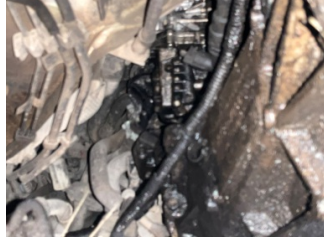
Motor, Motor > Yağ Kaçağı
