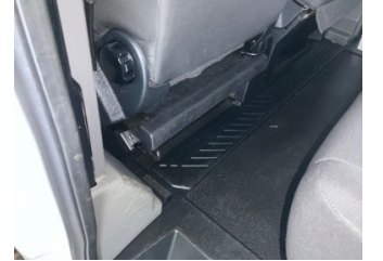
Döşemeler/Kapaklar, Döşemeler/Kapaklar > Çizik
