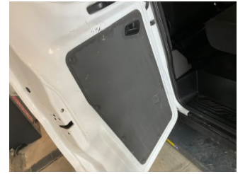
Döşemeler/Kapaklar, Döşemeler/Kapaklar > Deforme Olmuş
