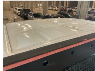
Tavan, Tavan > Hasarlı
