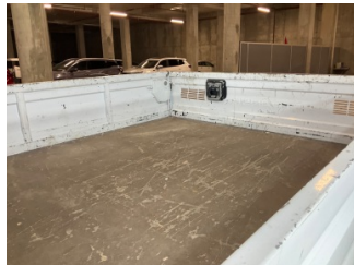
Döşemeler/Kapaklar, Döşemeler/Kapaklar > Deforme Olmuş
