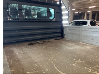
Döşemeler/Kapaklar, Döşemeler/Kapaklar > Çizik
