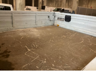
Döşemeler/Kapaklar, Döşemeler/Kapaklar > Deforme Olmuş
