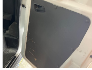
Döşemeler/Kapaklar, Döşemeler/Kapaklar > Deforme Olmuş
