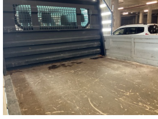
Döşemeler/Kapaklar, Döşemeler/Kapaklar > Deforme Olmuş
