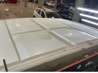
Tavan, Tavan > Hasarlı
