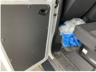
Döşemeler/Kapaklar, Döşemeler/Kapaklar > Deforme Olmuş
