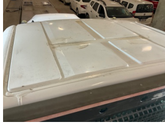
Tavan, Tavan > Hasarlı
