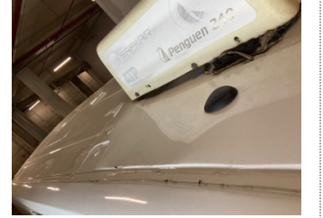
Tavan, Tavan > Hasarlı
