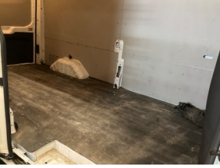
Döşemeler/Kapaklar, Döşemeler/Kapaklar > Deforme Olmuş
