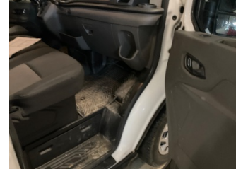
Döşemeler/Kapaklar, Döşemeler/Kapaklar > Deforme Olmuş
