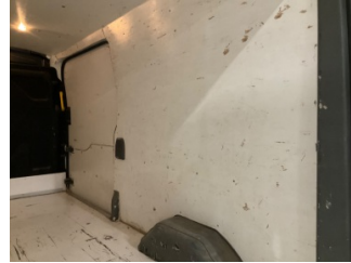
Döşemeler/Kapaklar, Döşemeler/Kapaklar > Deforme Olmuş
