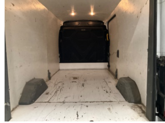
Döşemeler/Kapaklar, Döşemeler/Kapaklar > Kirlenmiş
