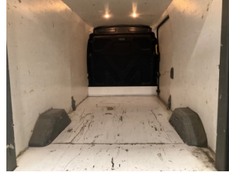
Döşemeler/Kapaklar, Döşemeler/Kapaklar > Çizik
