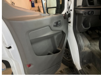
Döşemeler/Kapaklar, Döşemeler/Kapaklar > Deforme Olmuş
