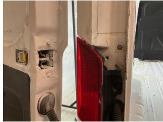
Bagaj kapağı/kapısı, Menteşe > Sökülmüş-Yok
