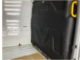
Döşemeler/Kapaklar, Döşemeler/Kapaklar > Çizik
