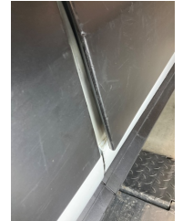
Kapı, sağ ön, Kapı bandı > Sabitlemesi Hatalı
