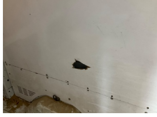
Döşemeler/Kapaklar, Döşemeler/Kapaklar > Hasarlı
