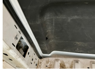
Döşemeler/Kapaklar, Döşemeler/Kapaklar > Hasarlı
