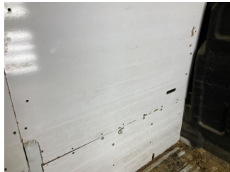
Döşemeler/Kapaklar, Döşemeler/Kapaklar > Deforme Olmuş
