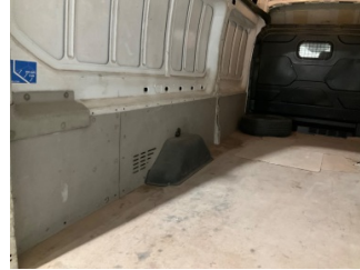
Döşemeler/Kapaklar, Döşemeler/Kapaklar > Kirlenmiş
