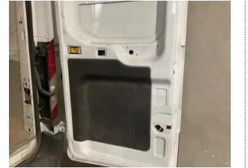
Döşemeler/Kapaklar, Döşemeler/Kapaklar > Çizik
