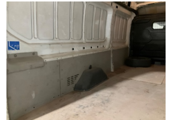
Döşemeler/Kapaklar, Döşemeler/Kapaklar > Deforme Olmuş
