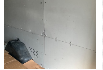
Döşemeler/Kapaklar, Bagaj bölümü döşemesi > Hasarlı
