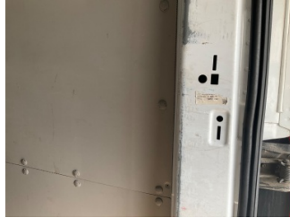
Döşemeler/Kapaklar, Bagaj bölümü döşemesi > Hasarlı
